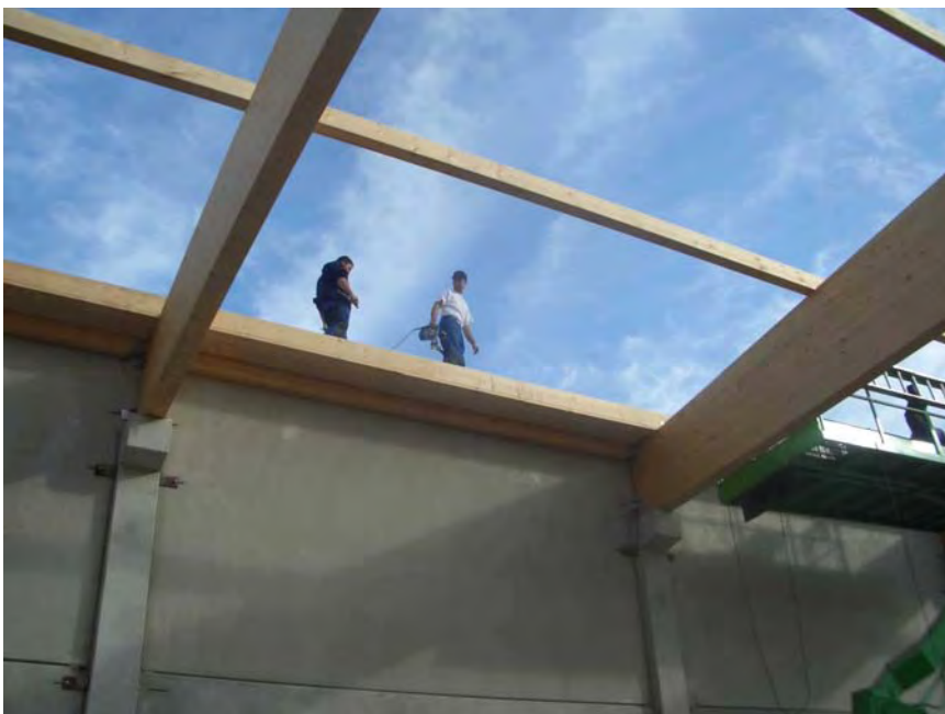
Arbeiten ohne ausreichende Absturzsicherung bei Hallenneubau
